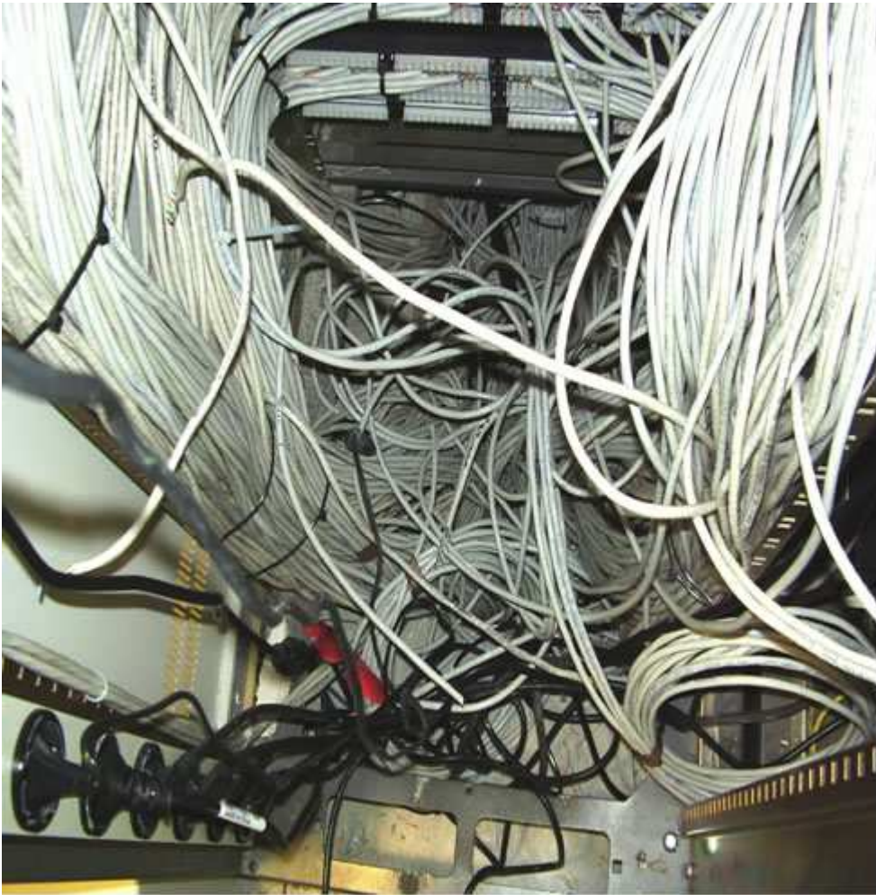
En esta fotografía se puede apreciar el estado de la parte posterior del rack de CLIENTE
