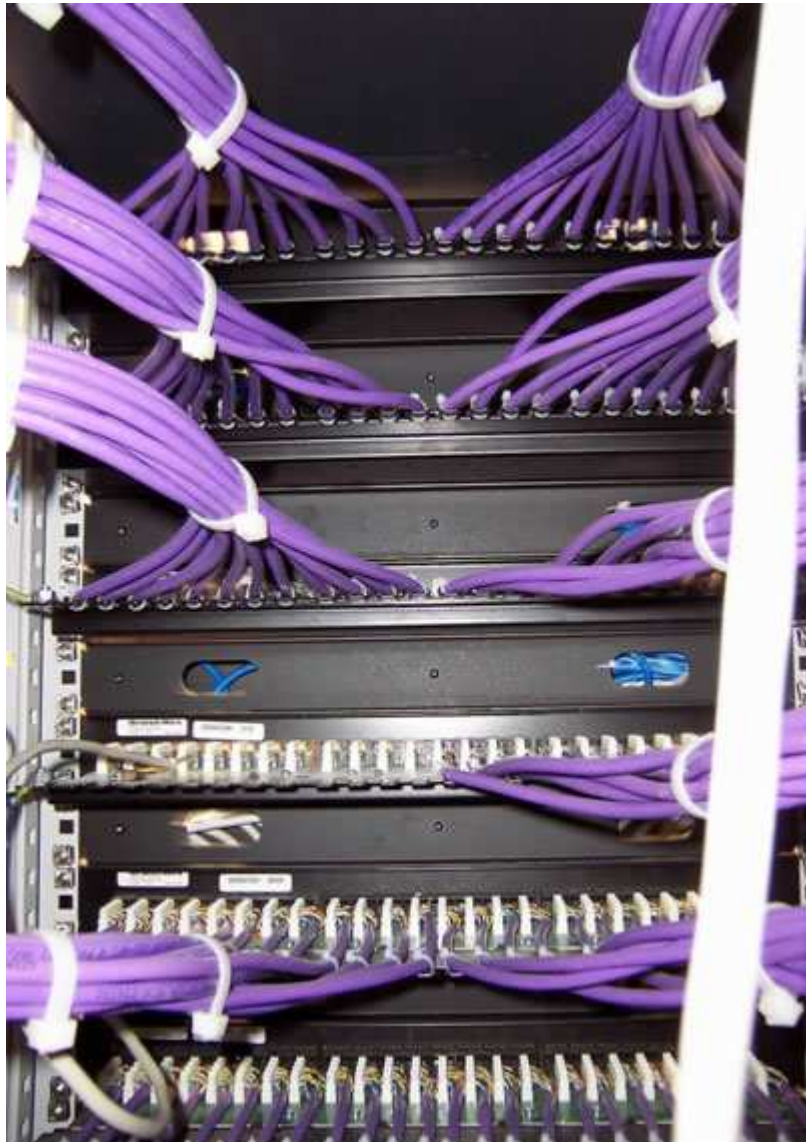
Ejemplo de la parte posterior de un rack conexionado por un técnico de Sylcom Redes y Comunicaciones, S. L.
