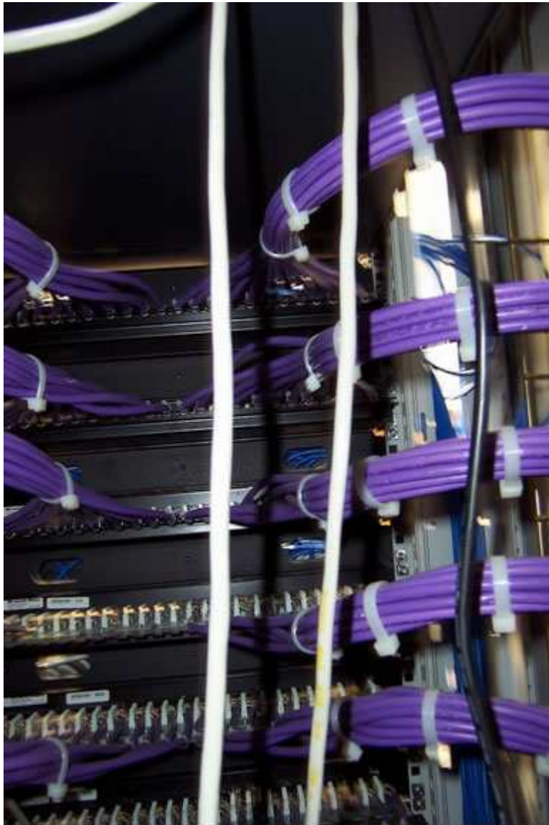
Otra imagen de la parte posterior de un rack conectado por un técnico de Sylcom Redes y Comunicaciones, S. L
